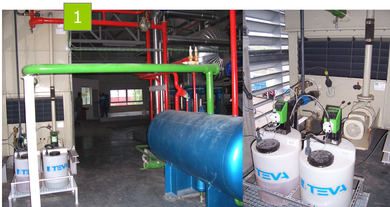
1 Condensador evaporativo en condiciones iniciales. En primer término equipo de medición y control de la conductividad, bomba de aportación de biocida e inhibidor de corrosión
