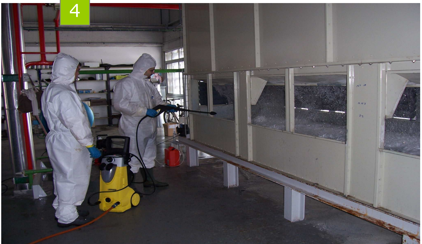
Limpieza física del condensador evaporativo (2): Utilización de equipos de limpieza de alta presión.
