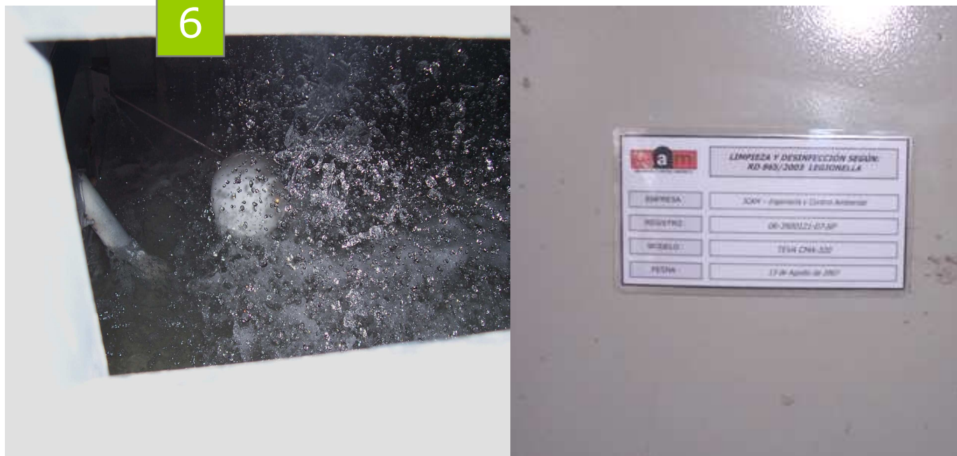
Normalización final de las condiciones del condensador evaporativo para alcanzar nuevamente el estado estacionario y emisión de certificado de limpieza y desinfección.
