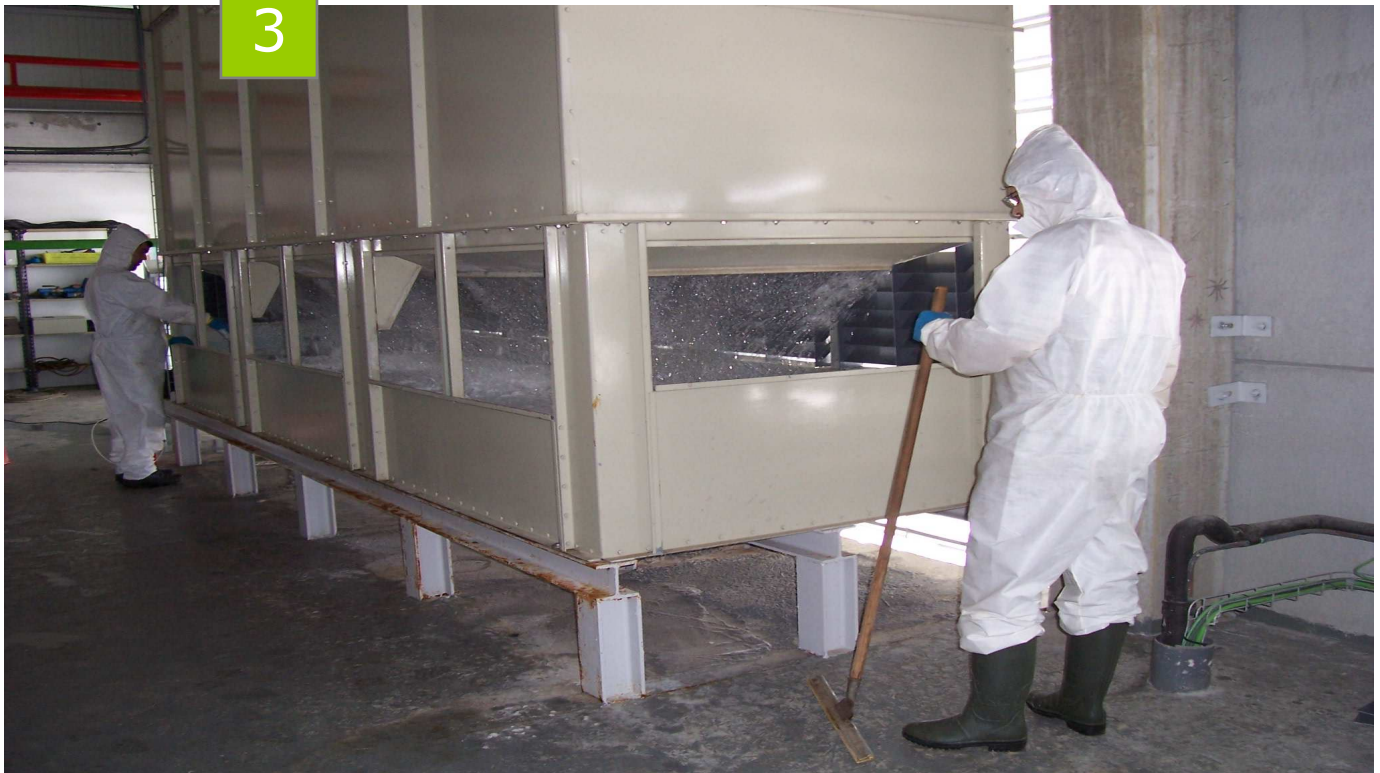
Limpieza física del condensador evaporativo (1): Utilización de medios manuales y agentes desincrustantes.
